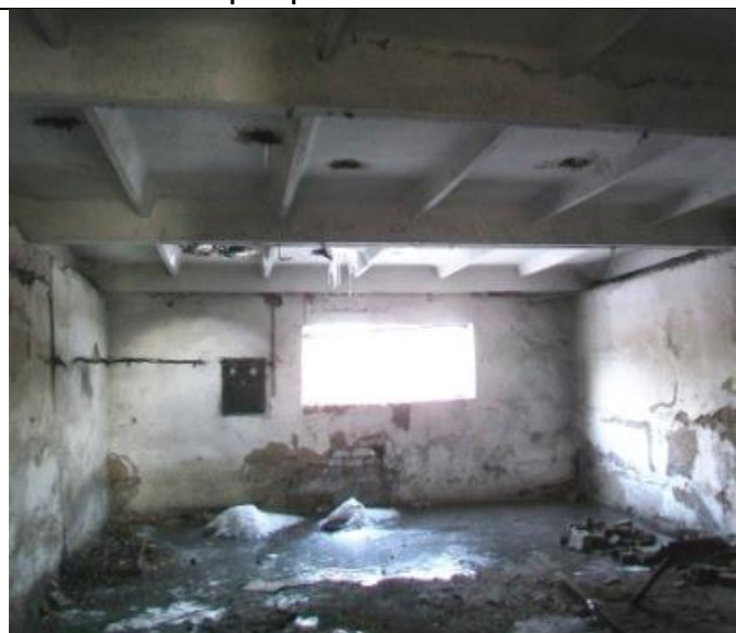
Котельная по Куйбышева 14, Насосная
