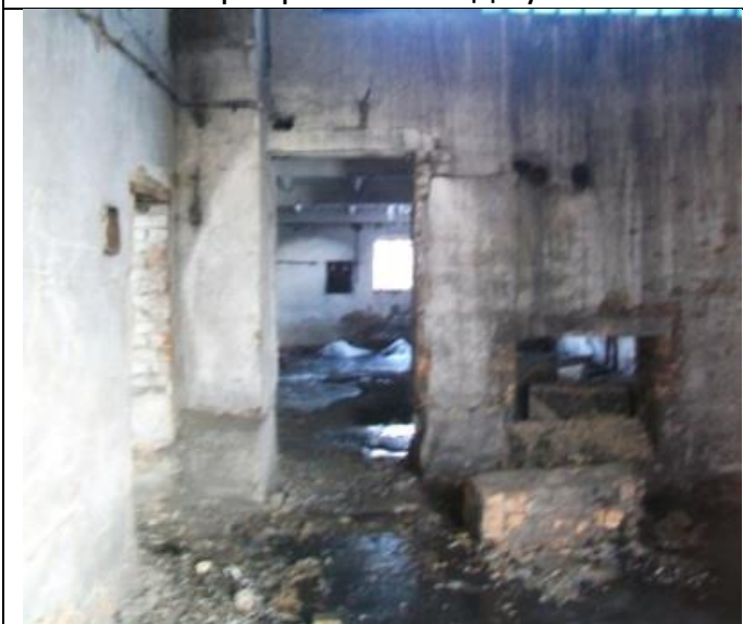
Котельная по Куйбышева 14, Склад угля, вход в насосную
