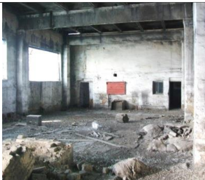
Котельная по Куйбышева 14, Зал для котлов
