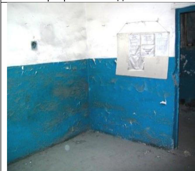
Котельная по Куйбышева 14, Тамбур на входе
