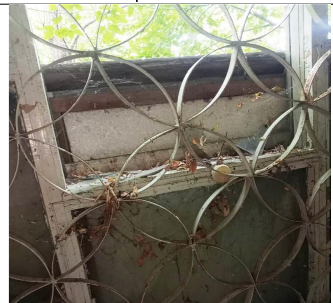
Здание магазина в Половинкино, Разбитые стёкла с фасада
