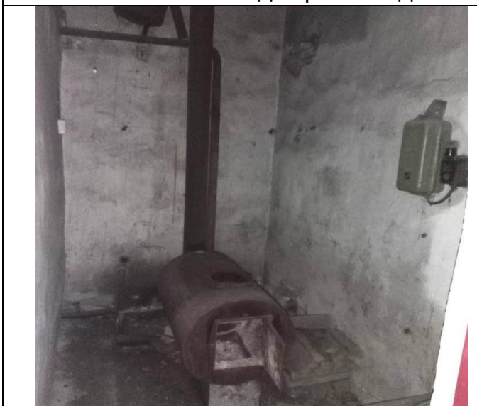
Здание магазина в Половинкино, Остатки системы отопления
