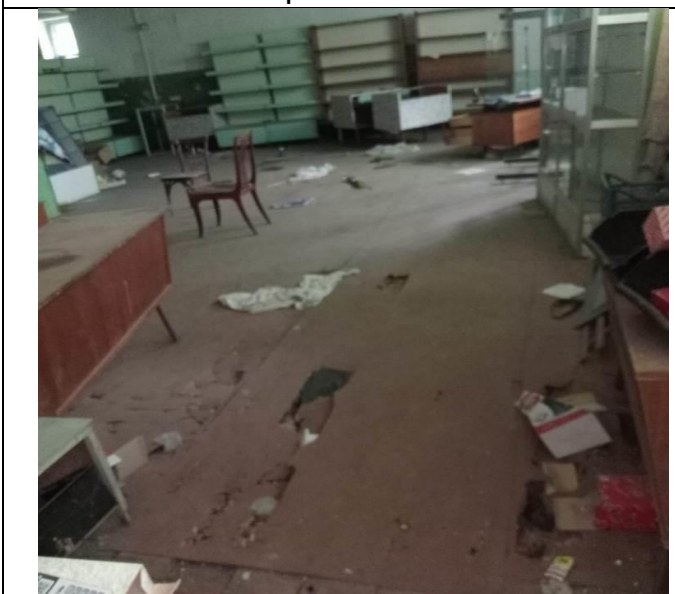
Здание магазина в Половинкино, Провалы деревянного пола
