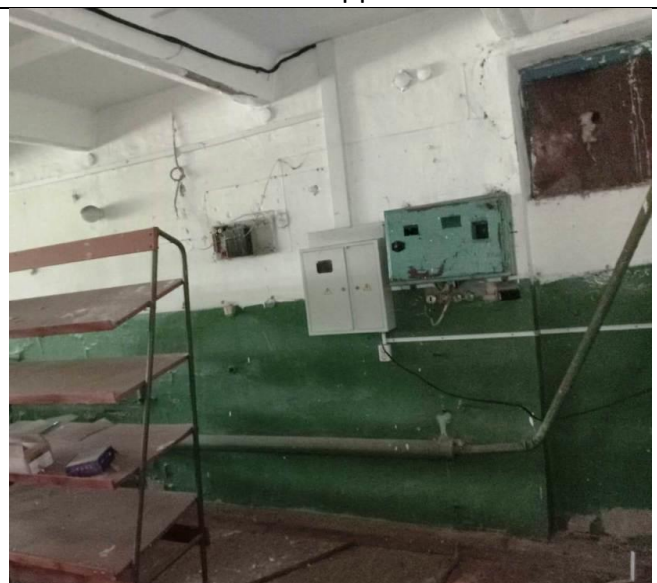
Здание магазина в Половинкино, Электрические щитки
