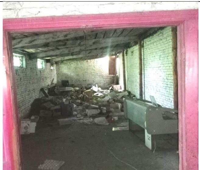
Здание магазина в Половинкино, Состояние холодного склада
