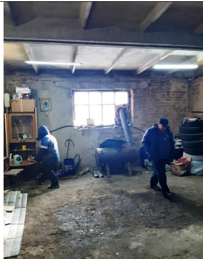
Гаражный бокс №2 по Митусовой 30а, Трещины в бетонном полу
